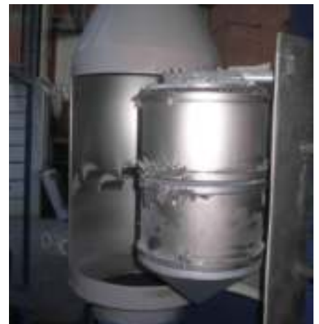
Een upside down gemonteerde pijpmagneet voor kunststof granulaat
